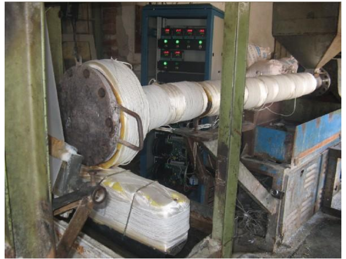
多个 10KW 和 5KW 在拉丝机中的应用
